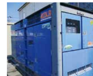
非常用の発電機
