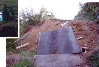
市道に発生した段差
