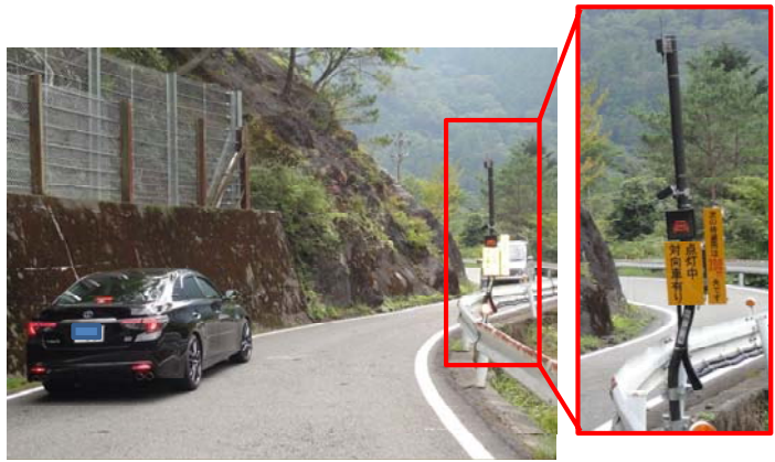
ゆずりあいロード支援システム設置状況
