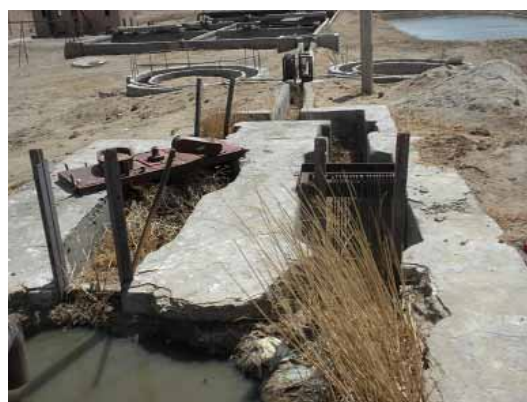
写真-4: 機能しない処理場(右奥にため池)
