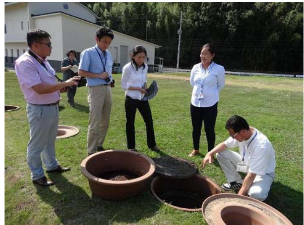
写真-6：土壌浄化法による汚水処理状況
