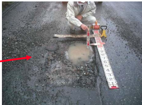
ポットホール発生状況 (試掘復旧箇所で舗装が薄かった。)
