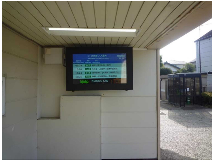
設置状況（近景）
