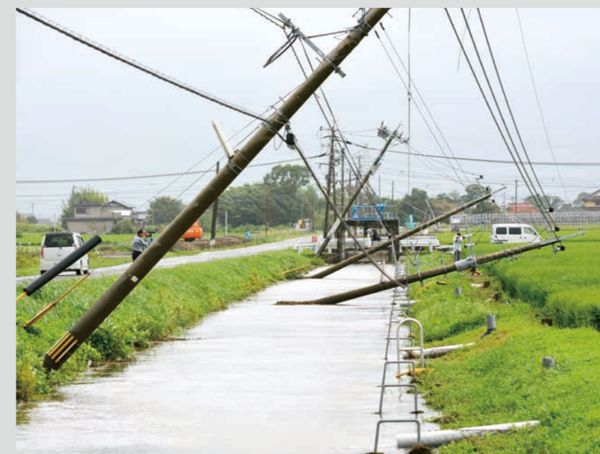
破損・水没した電柱や電線で感電する危険
