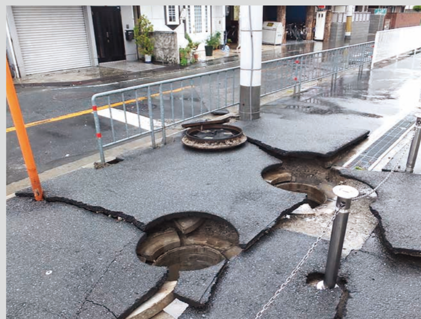
ふたが外れた側溝やマンホールに転落する危険
