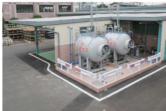
▲残ガス回収設備
