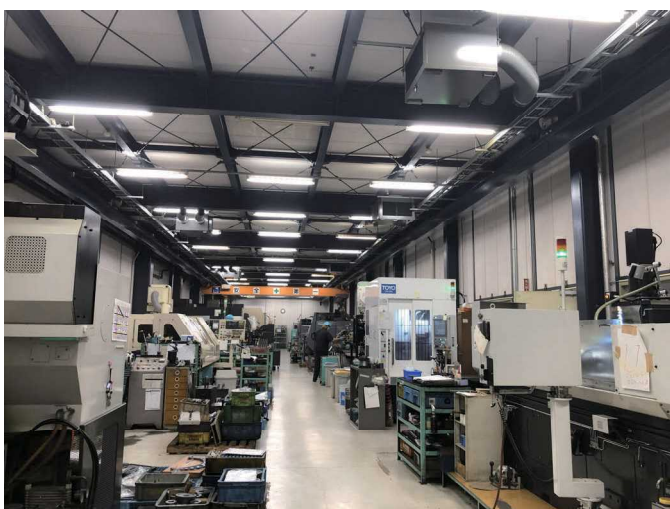
▲ 研削加工室の様子 天井に「オイルミストコレクター」を設置
