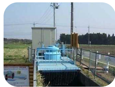
小水力発電所の整備
