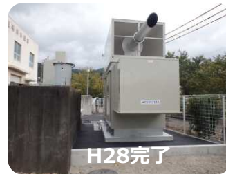
非常用発電装置の更新 （函南町畑毛排水機場地区）
