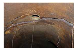
管にクラック
