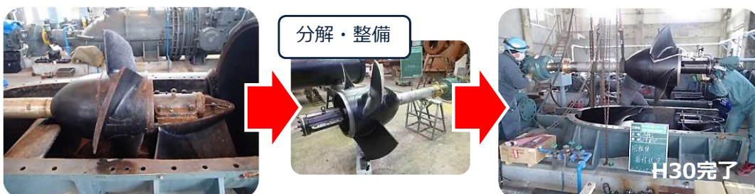
六間川排水機場（浜松市六間川排水機場地区）
