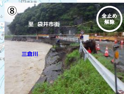
(主)袋井春野線 森町間詰 路肩欠損
