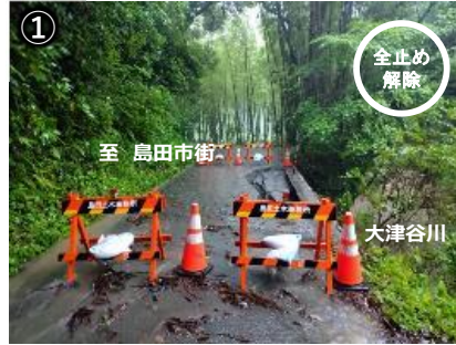
(-)伊久美元島田線 島田市大草 路面陥没
