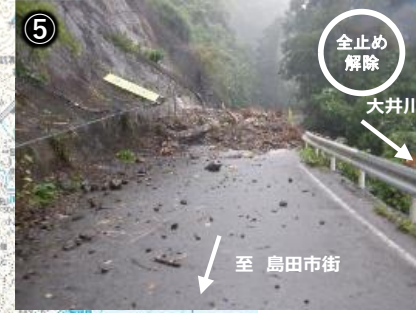
(国)473号 島田市川根町抜里 崩土
