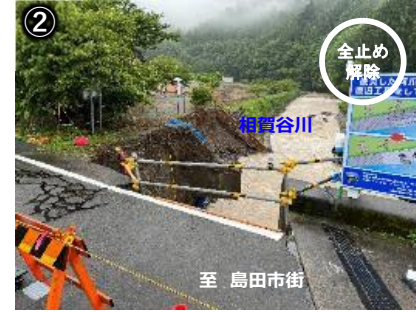
(主)焼津森線 島田市相賀 路肩欠損
