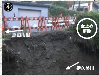
(主)蔵田島田線 島田市伊久美 路肩欠損
