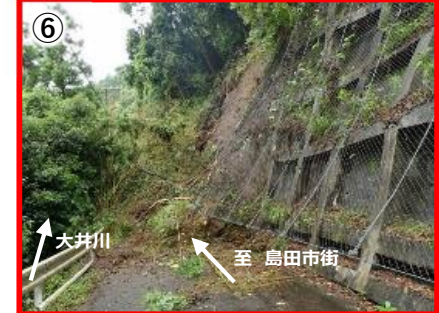
(国)473号 本川根町久野脇 崩土
