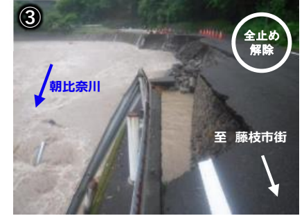
(-)相俣岡部線 藤枝市岡部町宮島 路肩欠損
