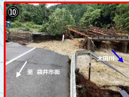
(-)大河内森線 森町鍛冶島 路肩欠損
