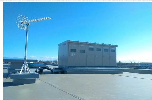
屋上 キュービクル
