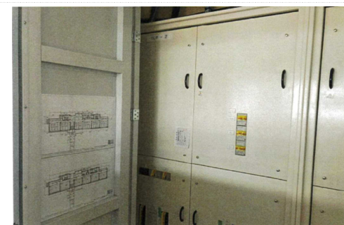
EPS 内に配線図を掲示
