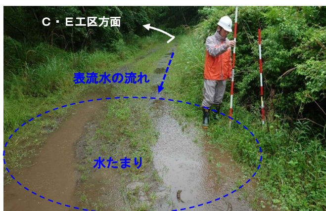
道路がE工区からD工区に向かって下り勾配になっており、D工区内に水たまりができています
