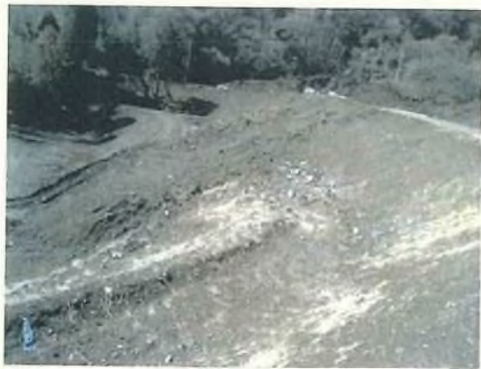
② 崩壊している法面の状況
