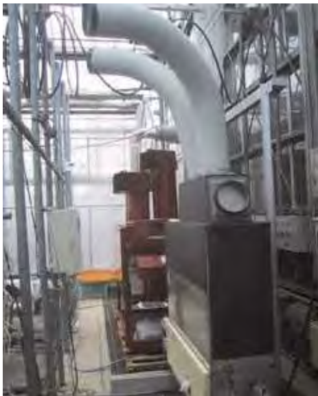
写真 2-1 試験に用いたヒートポンプと重油式温風暖房機
