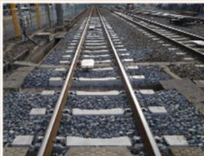
地域鉄道への支援 < 安全設備の整備 >
