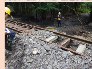
災害復旧 < 大井川鉄道本線 川根温泉笹間渡～千頭 >
