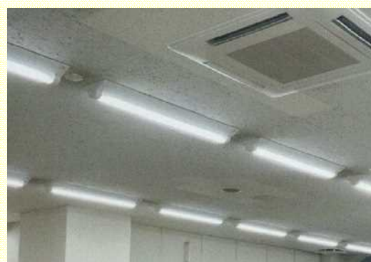
LED 照明への更新
