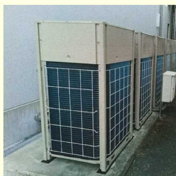
省電力空調機器への更新
