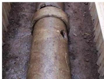
老朽化した管水路
